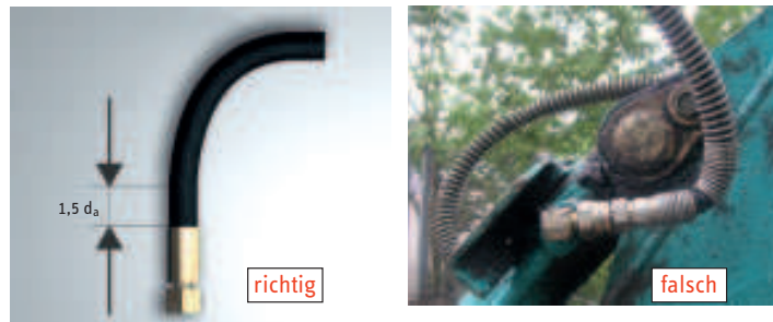
Abbildung 8: richtig - Gerader Abschnitt mit 1,5 d_a vor Biegung falsch - Eine Schlauchscheuerschutzspirale stellt keinen Knickschutz dar
